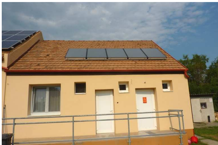
5. kép - napkollektor a konyha épület tetőszerkezetén
